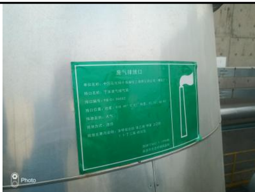
催化氧化装置（RCO）DA002 排气筒标识牌
