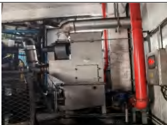
#1 亭多管冲击式除尘器
