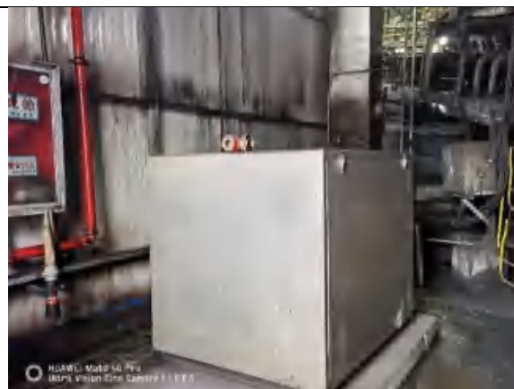
#1 亭干雾抑尘主机（#0 亭和#1 亭共用）
