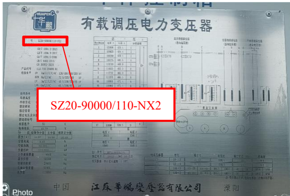
本期#1 主变铭牌照片
