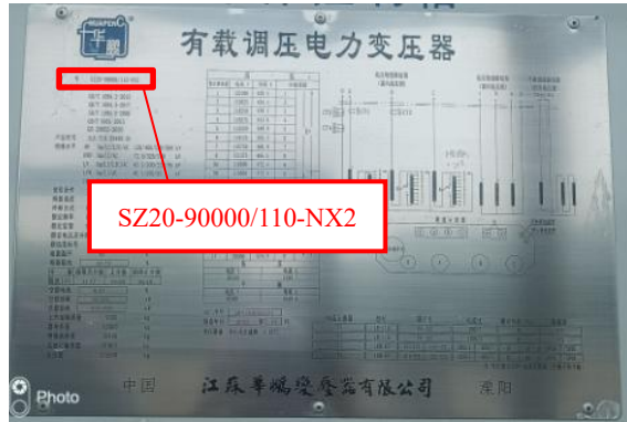
本期#2 主变铭牌照片
