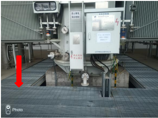
#2 主变下方事故油坑
