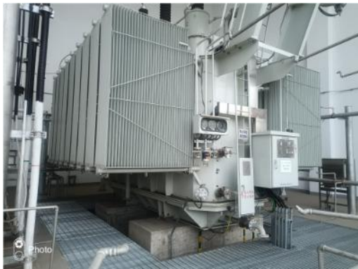
本期#1 主变照片
