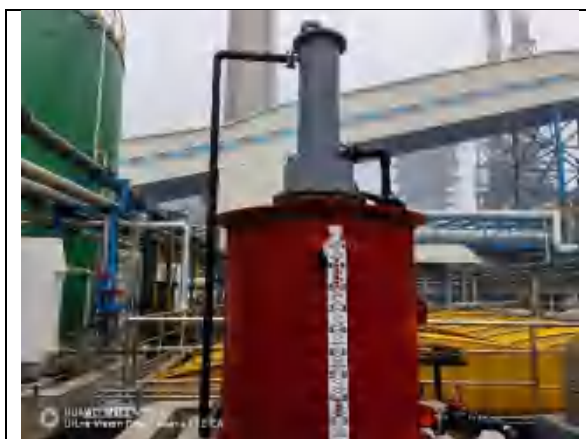
酸雾吸收器（盐酸罐顶部）
