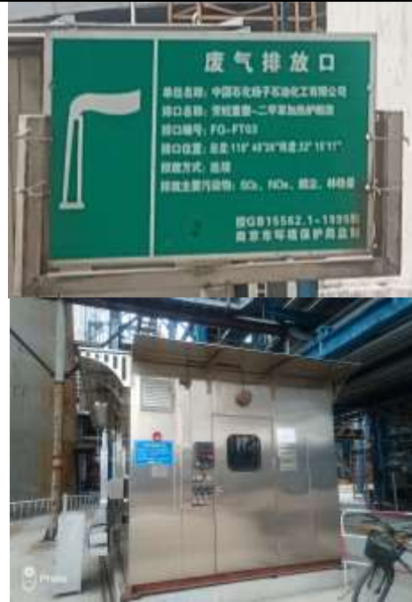
废气排放口标识和在线监测小屋
