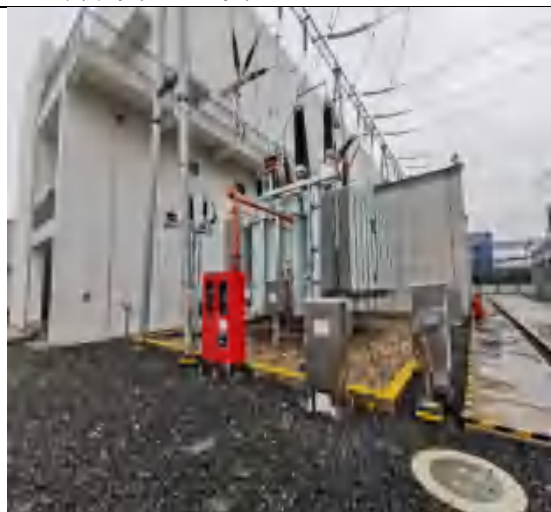
扬石二变 3#主变（220kV/150MVA）
