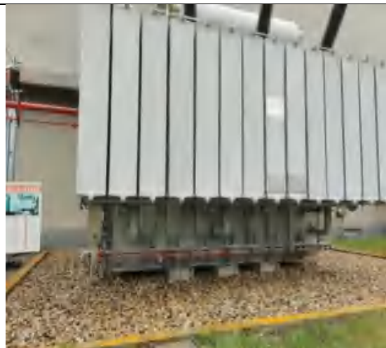
扬石变 14#主变（220kV/220MVA）
