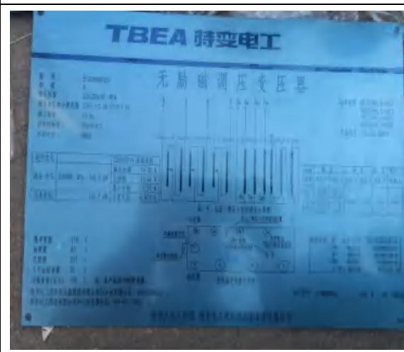
扬石变 14#主变（220kV/220MVA）铭牌
