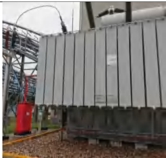
扬石变 13#主变（220kV/220MVA）
