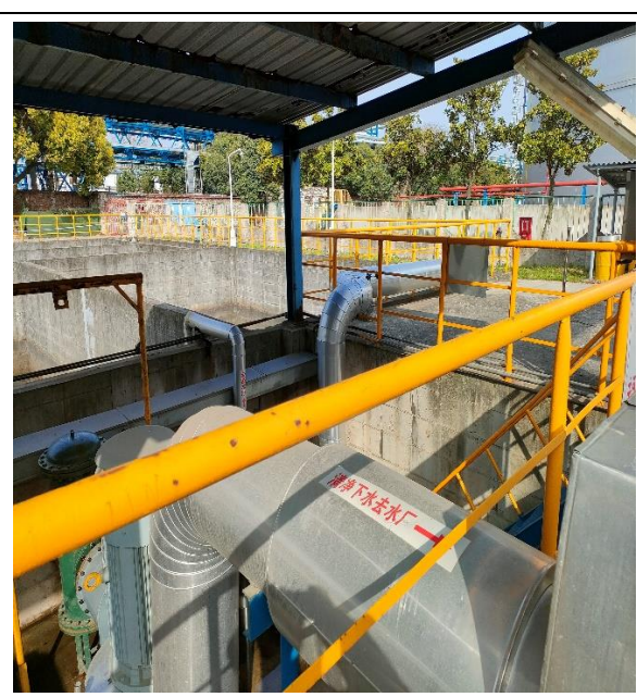
废水进水厂管道
