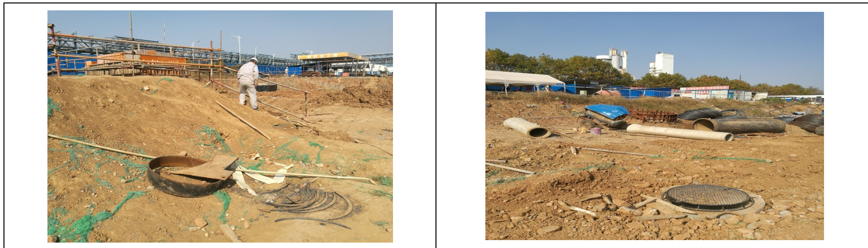
图片 2 一般固体废物（零星废旧金属、零散木块等杂物）未严格落实分类集中存放要求
