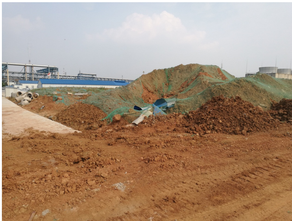
图片 1 裸土覆盖不到位
