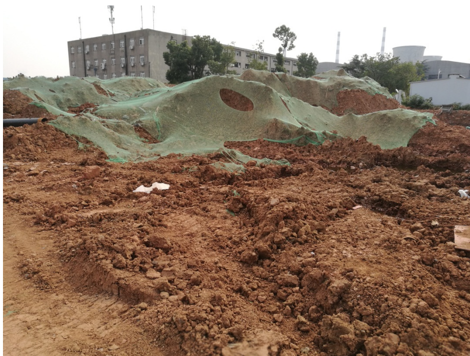
图片 2 裸土覆盖不到位和覆盖网破损
