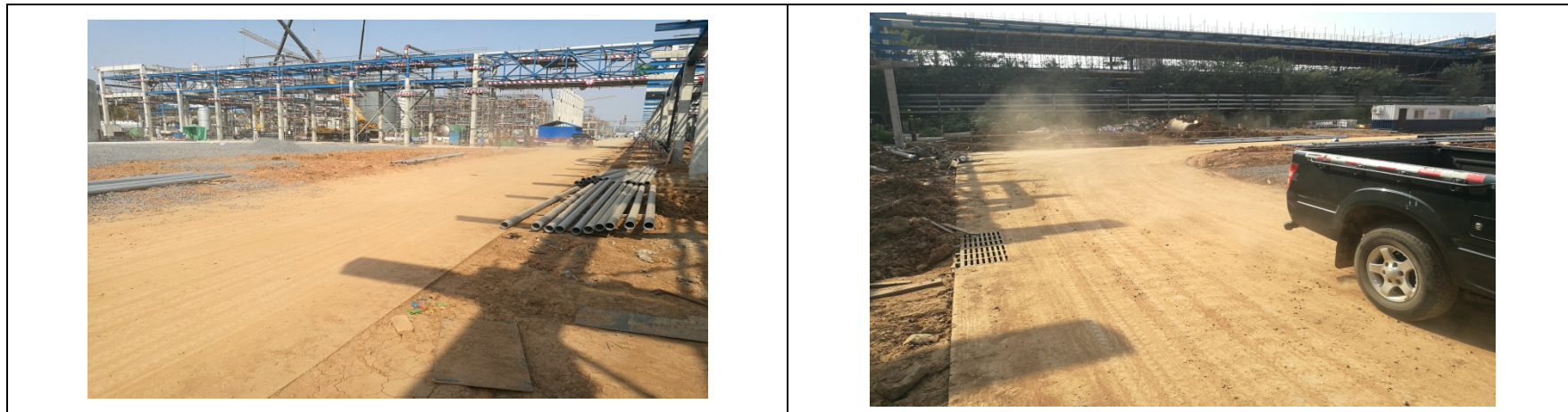
图片 1 车辆超速行驶扬尘和抑尘措施不到位
