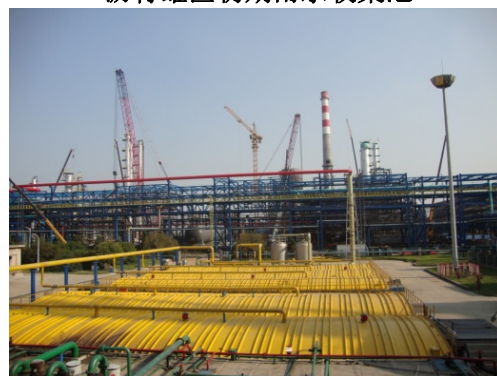
炼油厂污水预处理设施初期雨水收集池
