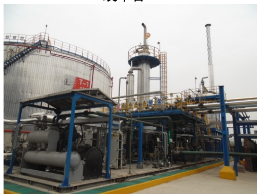
本项目依托的 VOCs 治理设施（单独验收）
