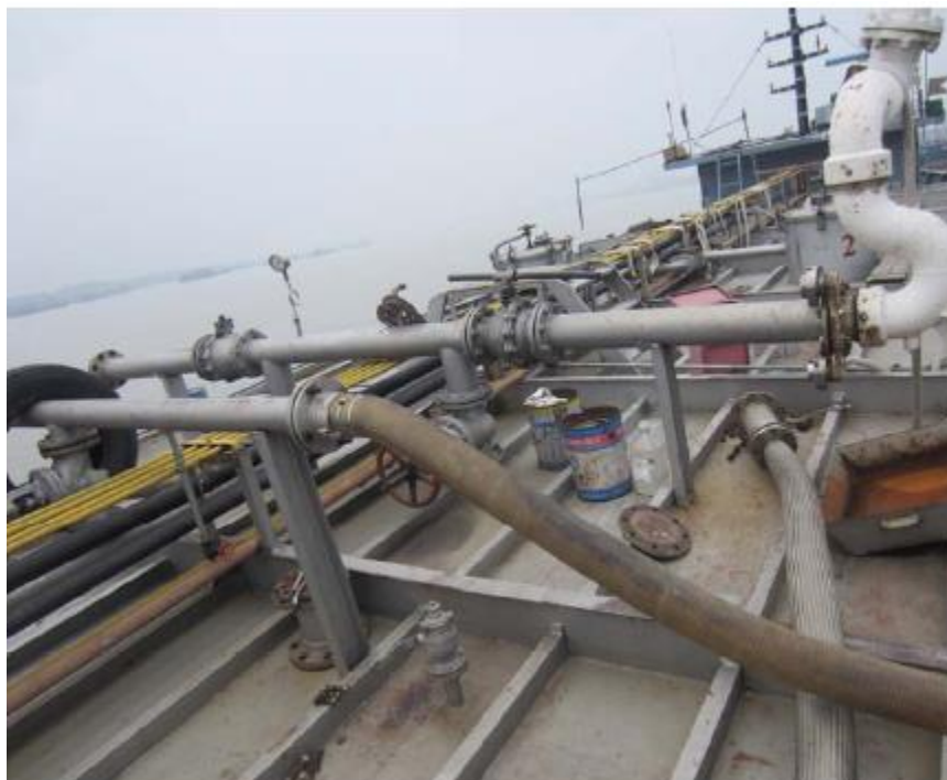
图 3.7-3 船舶船岸气相接口与软管连接
