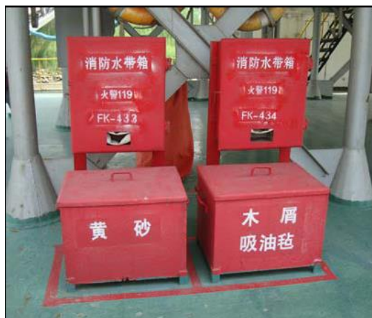
消防应急设备
