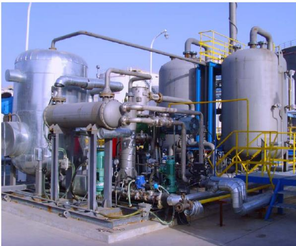
码头尾气回收装置
