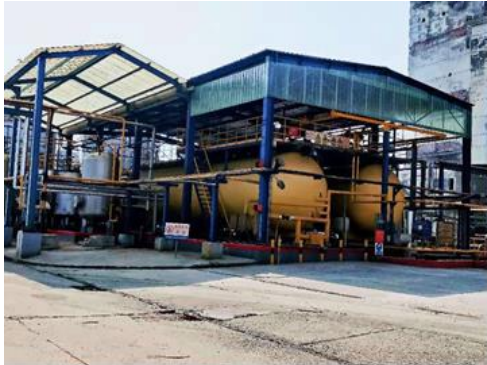
依托的氨水罐区
