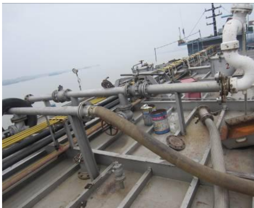
船舶船岸气相接口与软管连接
