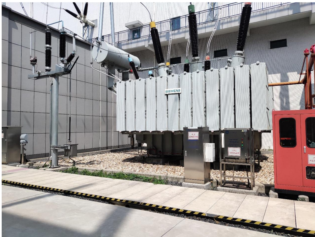
图 12 主变及下方事故油坑（1#主变）
