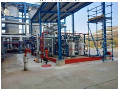
脱硝项目氨区
