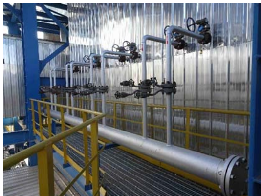
在线设备-氨喷淋及氨管线
