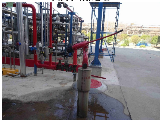
应急设备-消防炮
