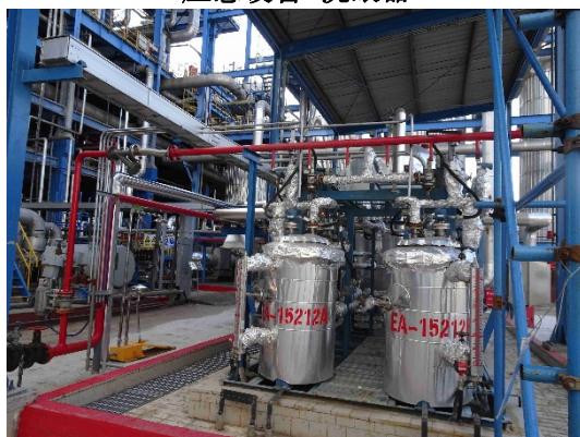
应急设备-消防事故喷淋
