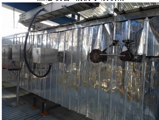
在线监测取样口
