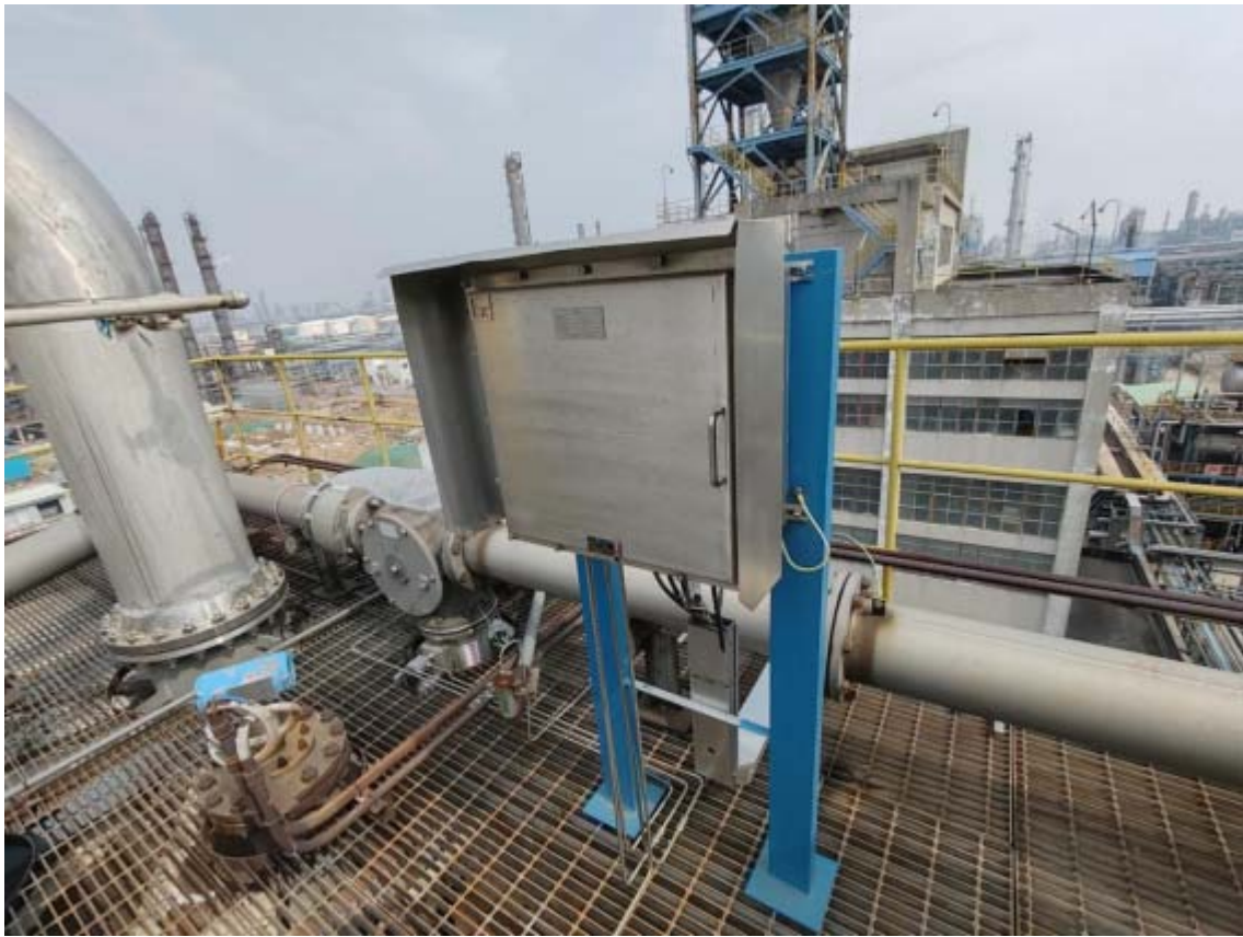
图 12 F502E 料仓静电监测消除系统仪表箱
