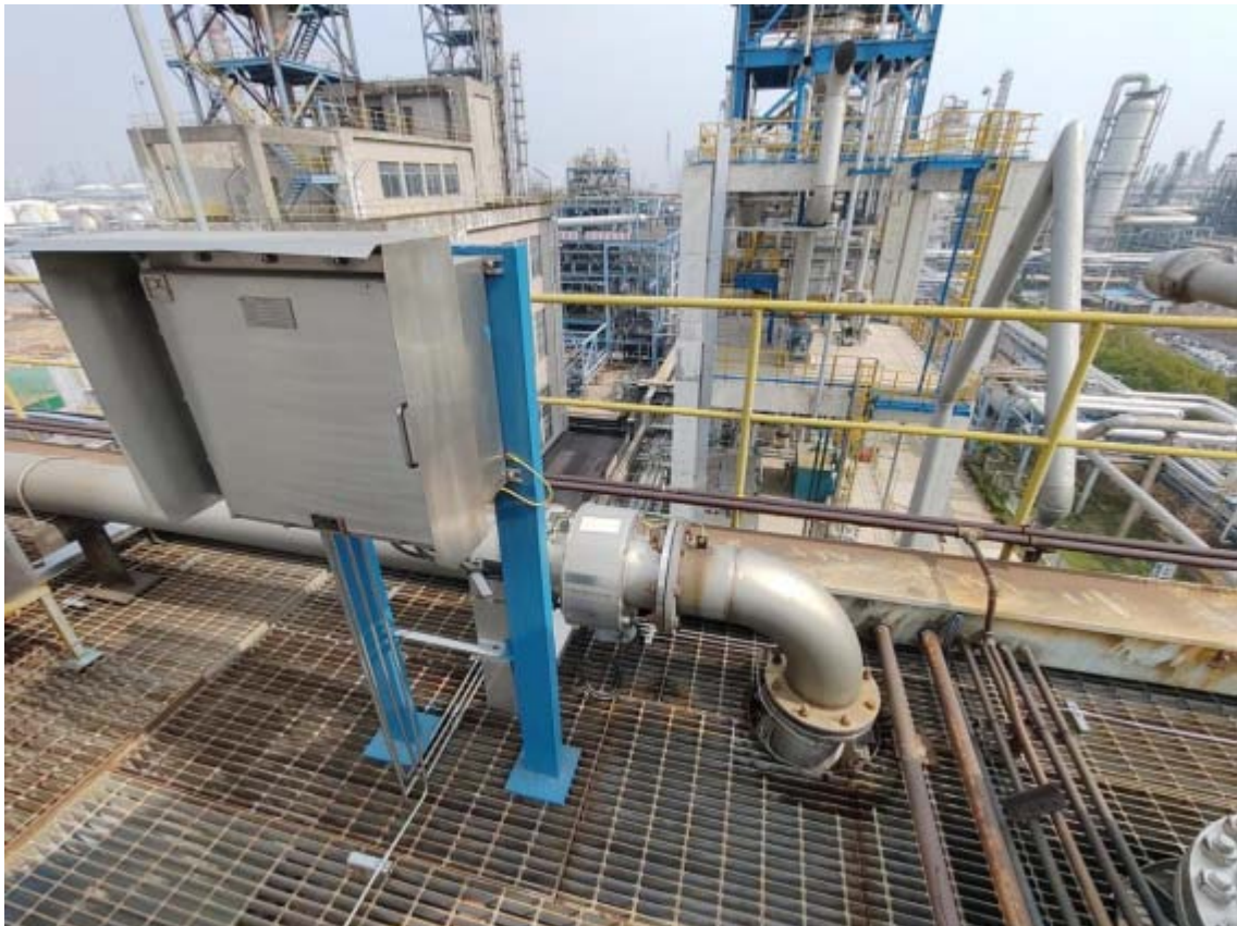
图 7 F502H 料仓静电监测消除系统仪表箱
