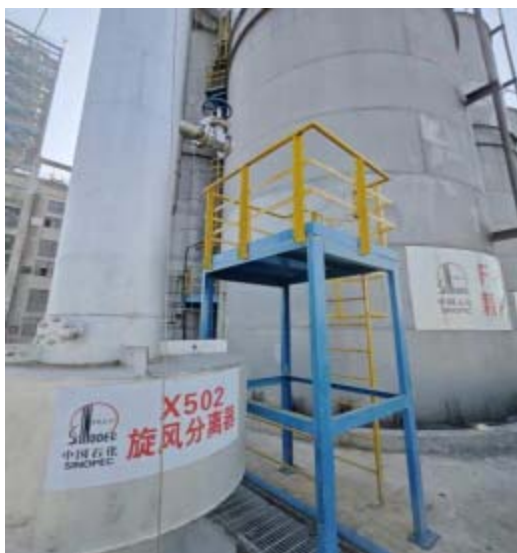
图 19 新增废气排口采样平台
