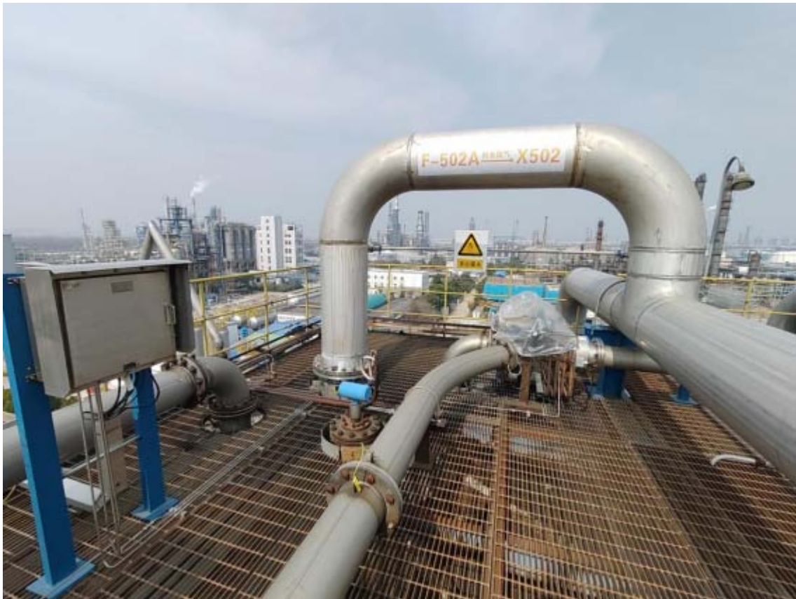
图 17 F502A 料仓静电监测消除系统仪表箱
