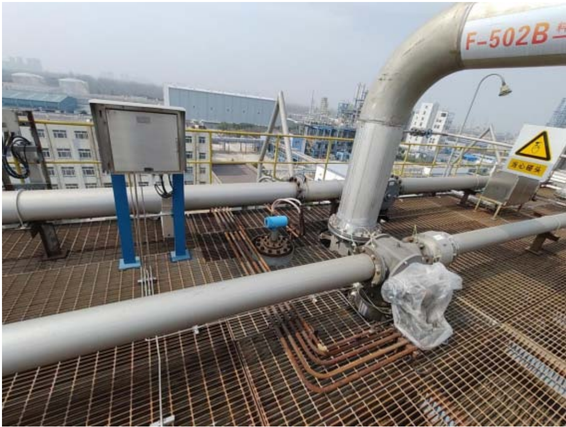
图 16 F502B 料仓静电监测消除系统仪表箱
