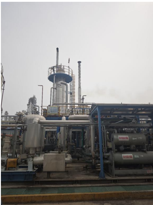
沥青罐改为油浆罐（净化油浆产品罐）呼吸气处理设施
