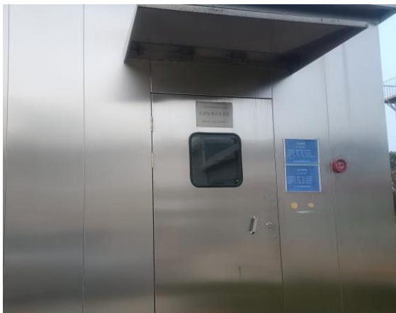
废水在线设施
