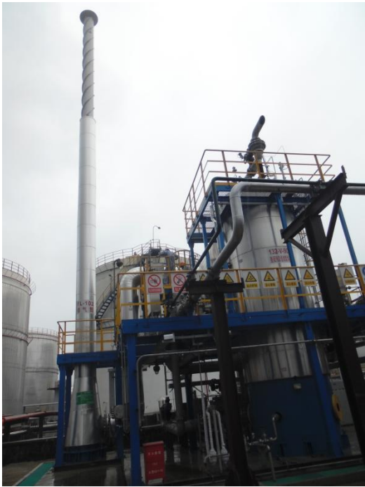
原油浆罐 V1007A/B 呼吸气处理设施
