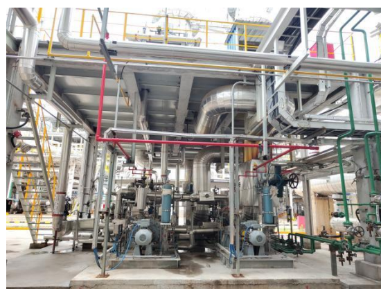
进料泵（15 万吨/年油浆脱固撬装设施）
