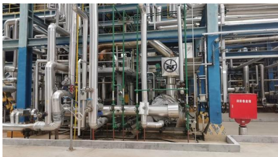
10.63 万吨/年油浆脱固撬装设施
