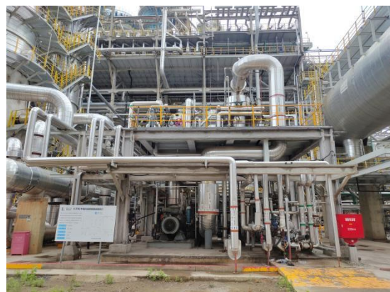
15 万吨/年油浆脱固撬装设施
