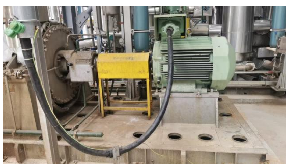
循环泵（10.63 万吨/年油浆脱固撬装设施）
