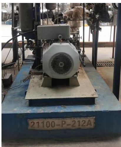
进料泵（10.63 万吨/年油浆脱固撬装设施）
