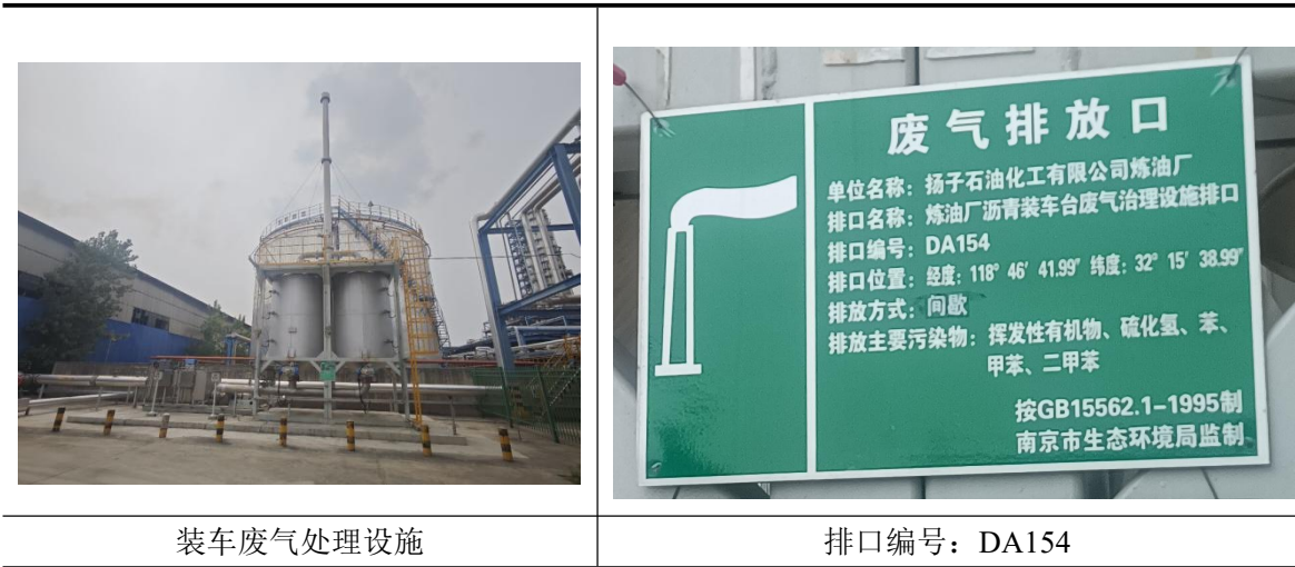
图 4-6 项目废气治理设施
