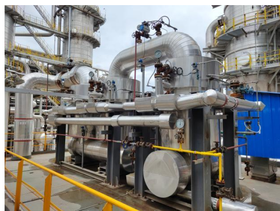
膜过滤器（15 万吨/年油浆脱固撬装设施）
