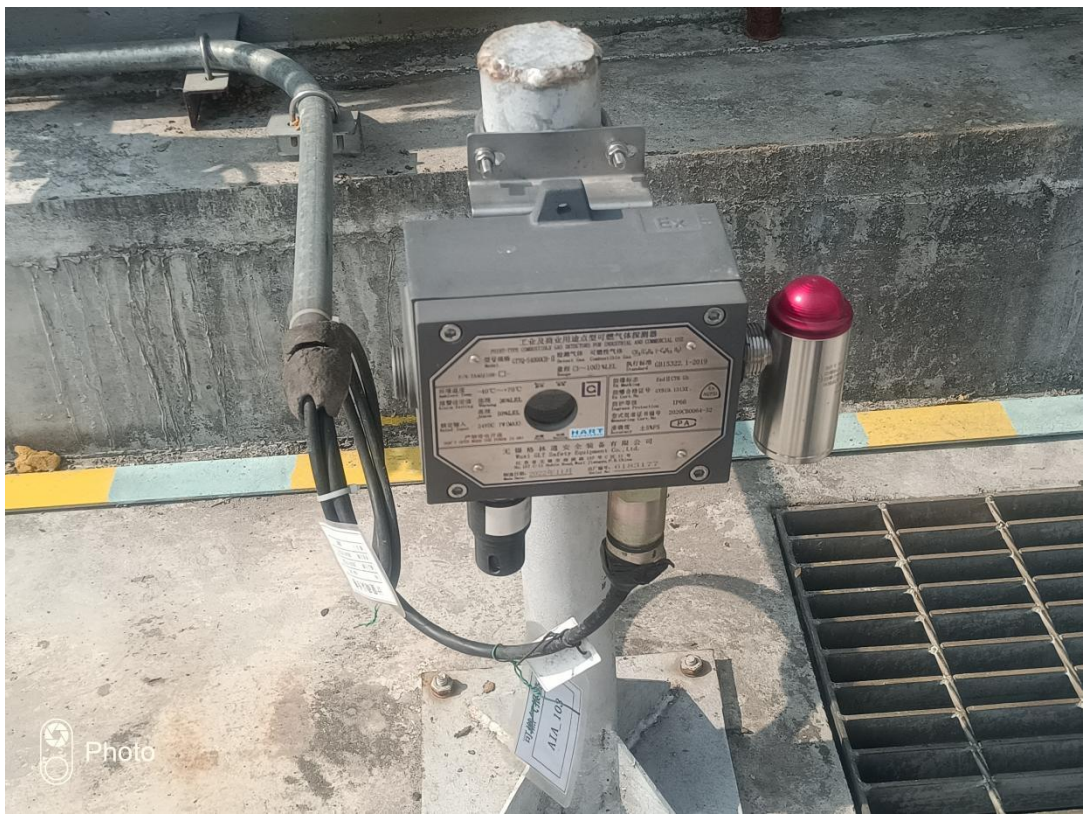
本项目所配备的可燃气体报警仪
