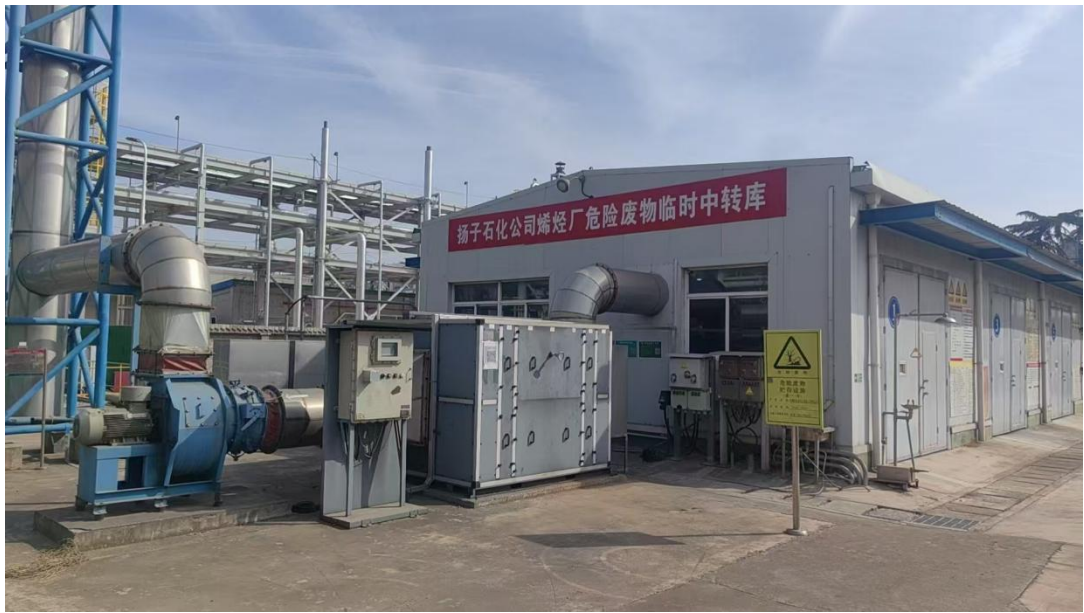
本项目所依托的危废暂存间
